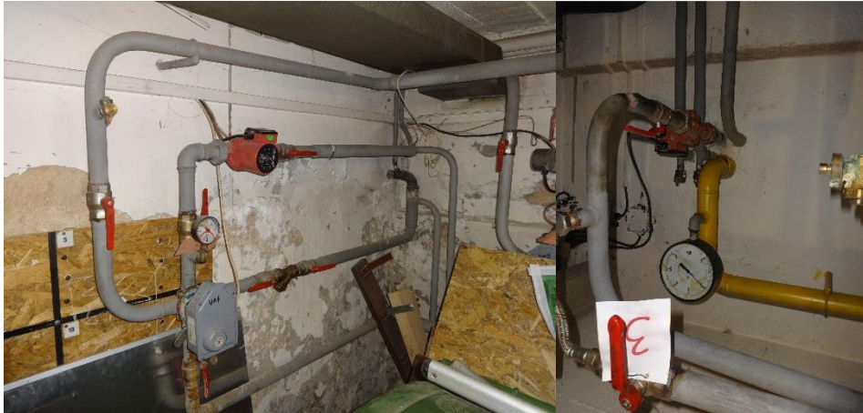
Obr. 5 Rozdelenie distribučného potrubia vykurovacieho systému na tri vetvy, sústava obehového čerpadla a regulácie teploty vody štvorcestným ventilom so servopohonom.
