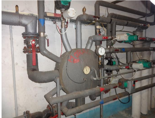
Obr. 1 Rozdeľovač a zberač vykurovacieho systému, sústava obehových čerpadiel a servoregulácie trojcestných ventilov teploty vody.
